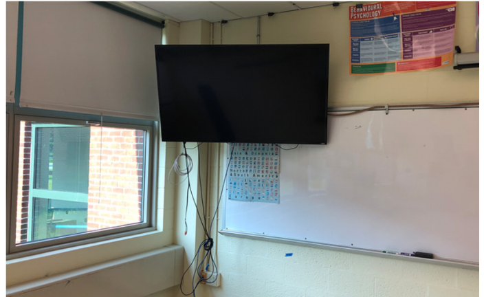
Photo of typical classroom AV display
