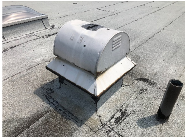
Kitchen Exhaust Fan
