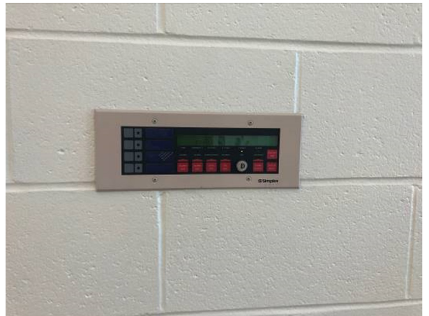
Fire Alarm Annunciator
