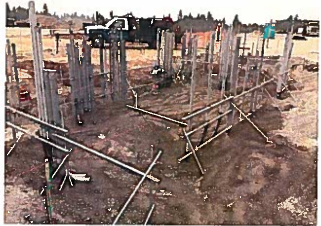
Main electrical room conduits
