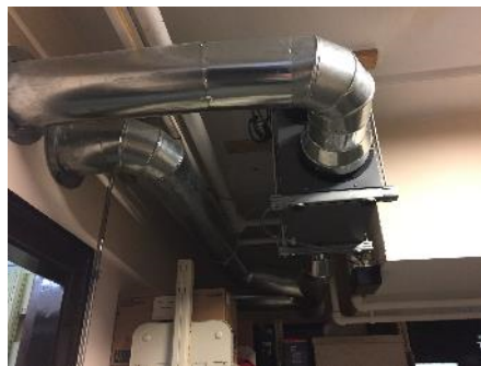
New Fan Coil Unit
