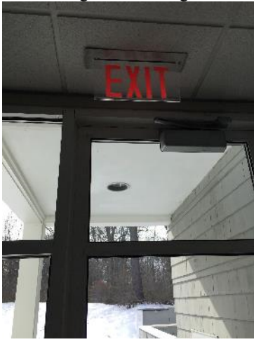
Edge Lit Exit Sign
