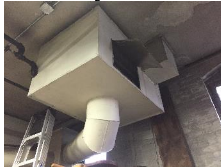
Existing Plenum Box
