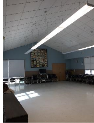
Pendant Fluorescent Fixtures
