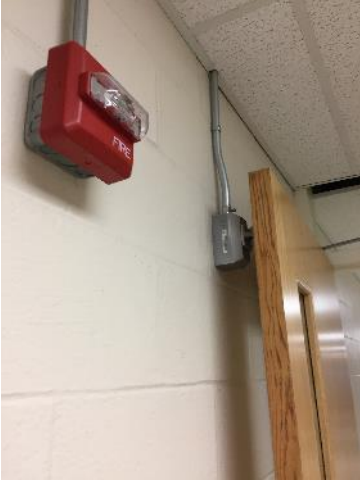
Fire Alarm Strobe, Door Holder
